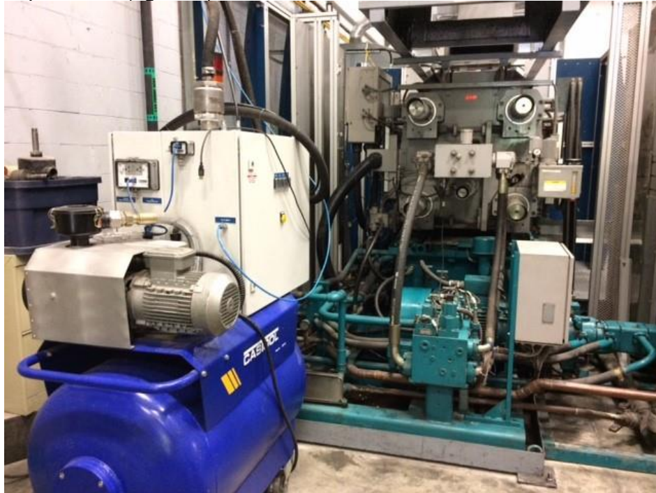
Figure 8. Pompe et réservoir de vide
