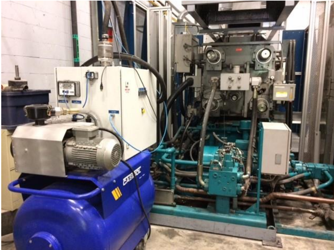
Figure 6. Moteur et réservoir hydraulique à arrière de la presse
