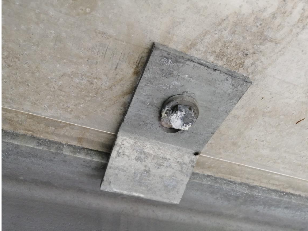
Figure 4-2 : Présence de corrosion sur un boulon aveugle situé sous le platelage (crédit photo : Centre de recherche sur l'aluminium – REGAL, juillet 2019).
