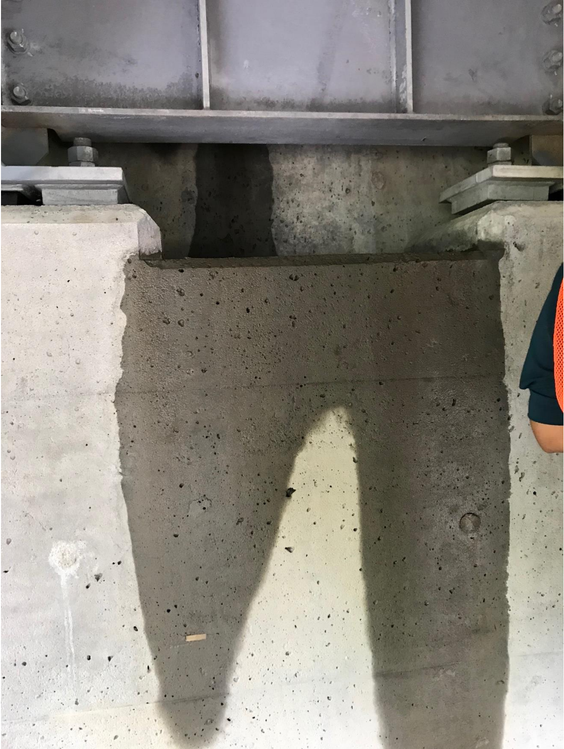
Figure 4-5 : Infiltration d'eau entre le paltelage et la chaussée.
