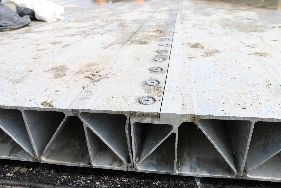
Figure 2-3 : Connexion mécanique entre les deux sections de platelage (crédit photo : Centre de recherche sur l'aluminium – REGAL, juillet 2015).
