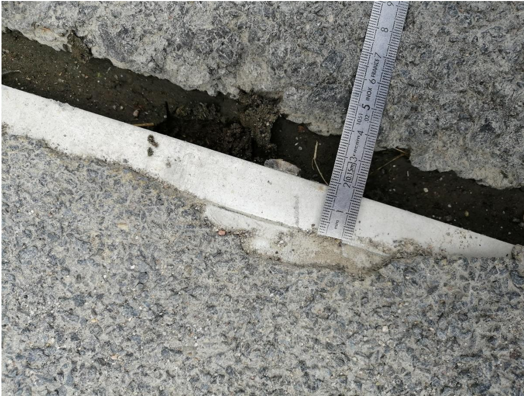
Figure 4-4 : Décollement de la surface de roulement (crédit photo : Centre de recherche sur l'aluminium – REGAL, juillet 2019).
