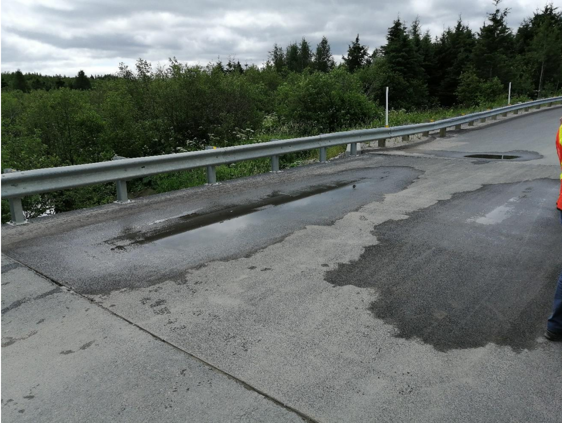
Figure 4-1 : Accumulation d'eau sur le pont (crédit photo : Centre de recherche sur l'aluminium – REGAL, juillet 2019).
