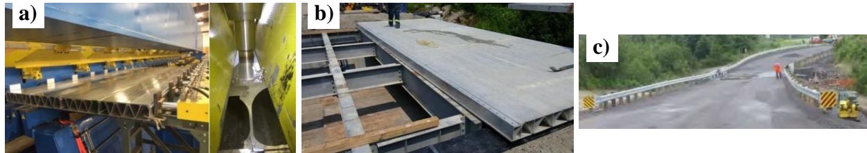
Figure 2.2 - Tablier de pont en aluminium a) soudage des extrusions b) installation c) produit fini [9]
